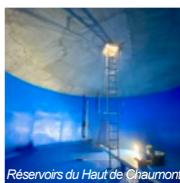
Réservoirs du Haut de Chaumont
