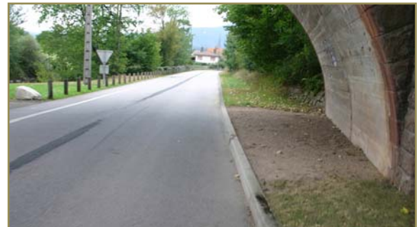
Le pont situé rue Louis Aubry ne permet pas le cheminement doux jusqu'au centre ville.
